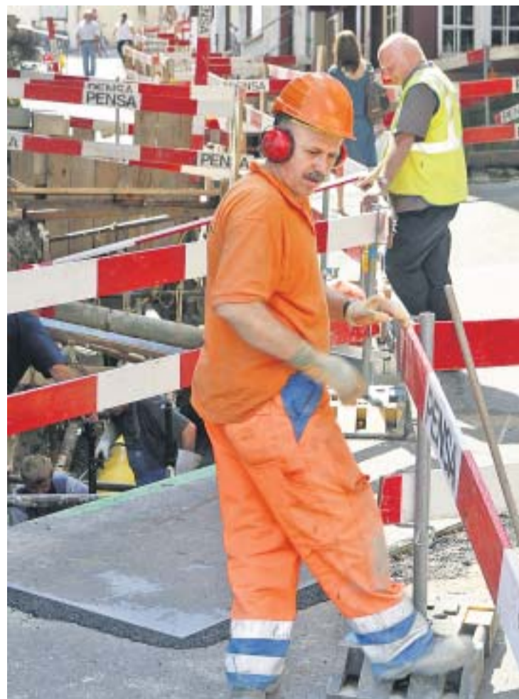
Grossbaustelle mit vielen Baugruben. Arbeiter erneuern derzeit Leitungen und Kanalisation am Rheinsprung.
